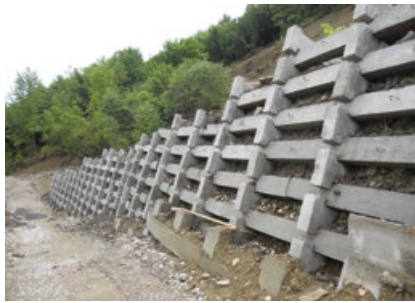
Klizište Ponir 2 na lokalnom putu Rebrovac - Ponir
